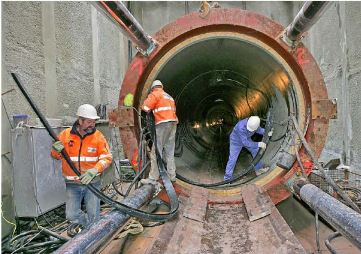
Das am Oberen Stephansberg angewandte Verfahren ist ähnlich dem beim Tunnelbau: Riesenrohre werden verpresst.
