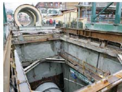
30 Tonnen wiegt jedes der Rohre, die hier auf ihren Einbau warten. Sie werden einzeln nachts als Schwertransport mit Polizeibegleitung angeliefert.
